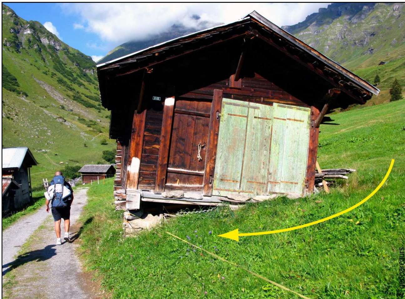
Grange située le long du chemin dans la zone de glissement de la Gimmela. Elle s'est « assise » au fil du temps, le terrain ayant flué vers l'aval.
